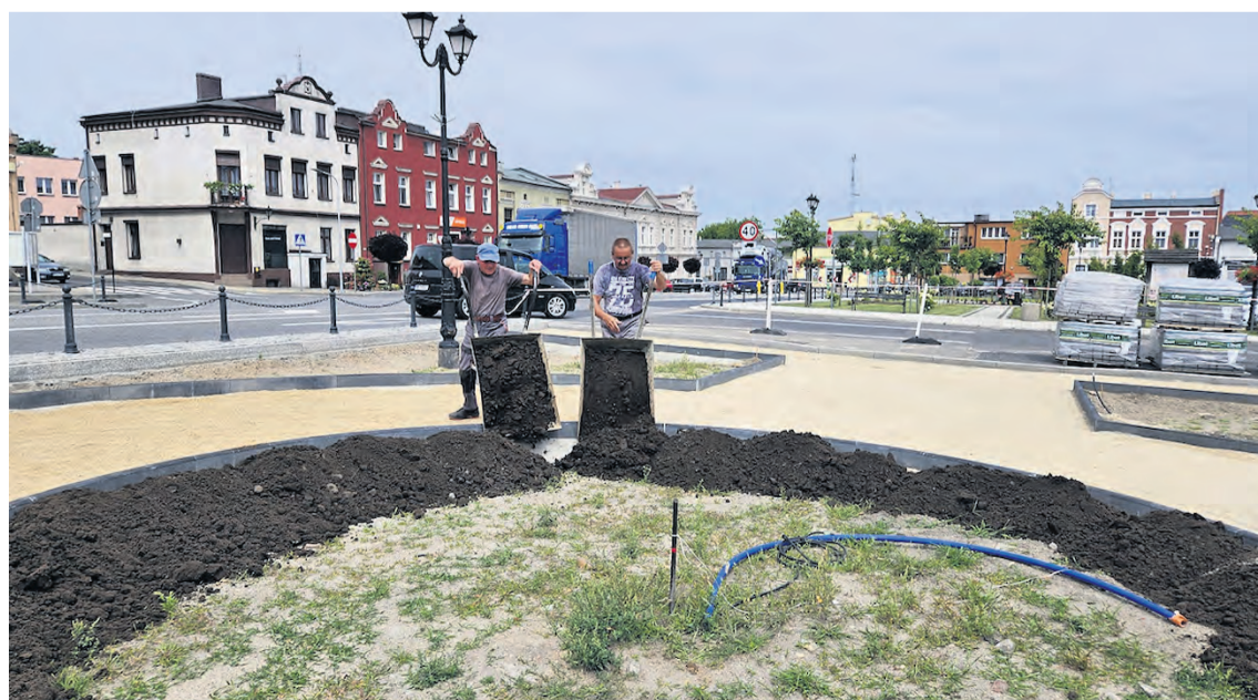
▲ Prace na rynku wykonują pracownicy tzw. gminnej ekipy gospodarczej. Zakup materiałów i roślin to koszt ponad 70 tys. zł
